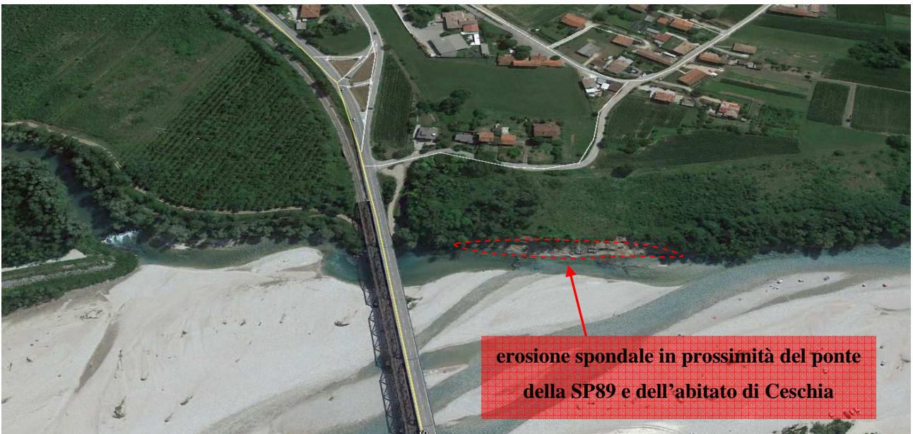
Figura 10: EROSIONE III - anno 2015
